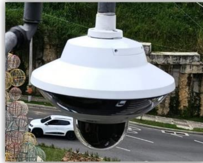
Mantenimiento y renovación Cámaras de seguridad (sistema de CCTV) que estaban fuera de servicios y estaban obsoletas. PTZ a Multisensor.
