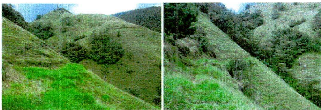
Tramo donde se disminuye la banca a 2 m por derrumbes y goteras de bosque por donde cruza el camino.
